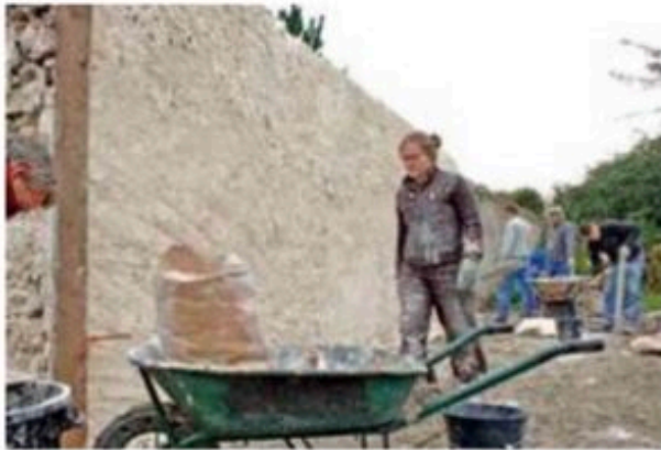
160 mètres de murs ont été restaurés dans le cadre de chantiers participatifs. © Ville de Montreuil
